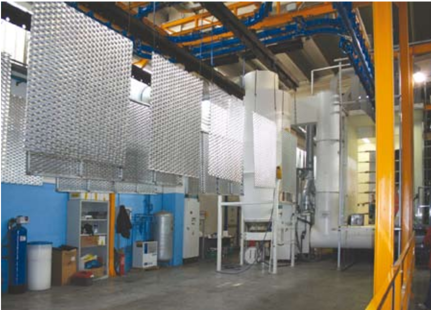
1 - Détail de l'installation de peinture poudres et liquide opérationnelle chez Maxicolor de Oppeano (Vr).
