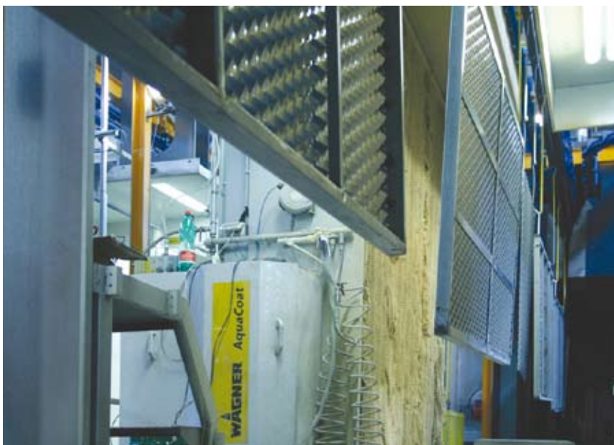
4 - La cabina automatica di verniciatura liquida all'acqua.
