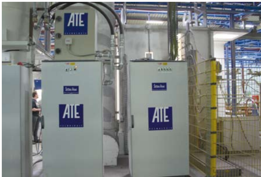
5 - Deux des trois unités Système Atimix installées chez Silac.
