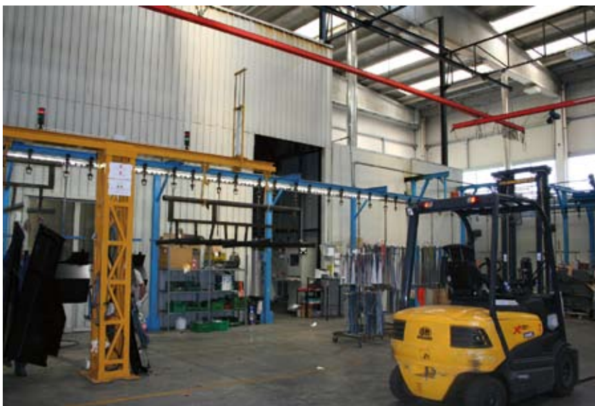
10 - Vista del nuovo impianto automatico a polveri a cambio colore rapido.
