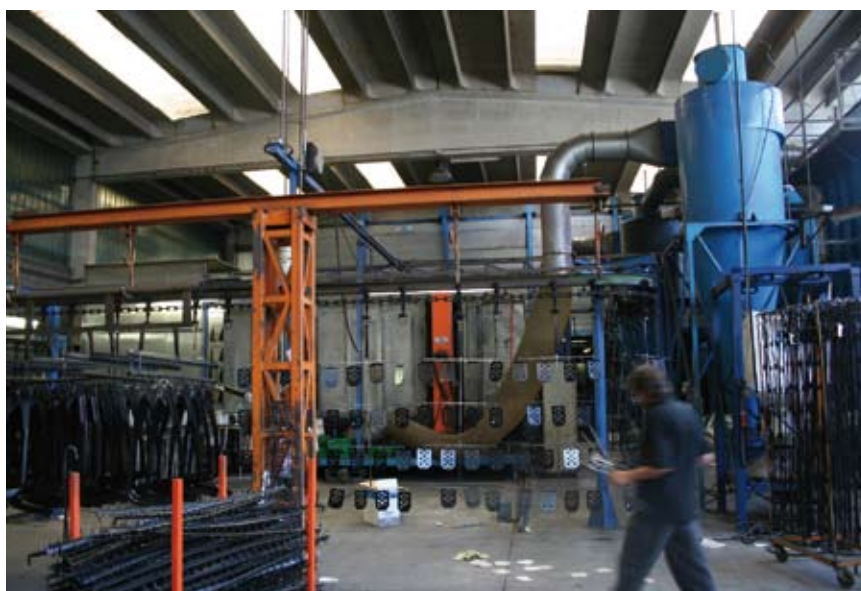
7 - Vista generale dell'impianto continuo a polveri per pezzi di piccole/medie dimensioni.
