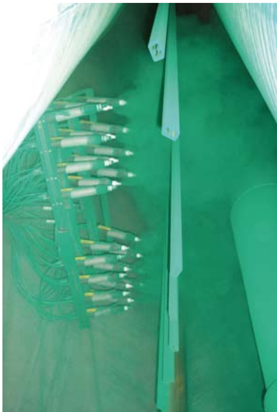
3- Particolare delle pistole erogatrici dell'impianto verticale installato presso l'azienda francese.
