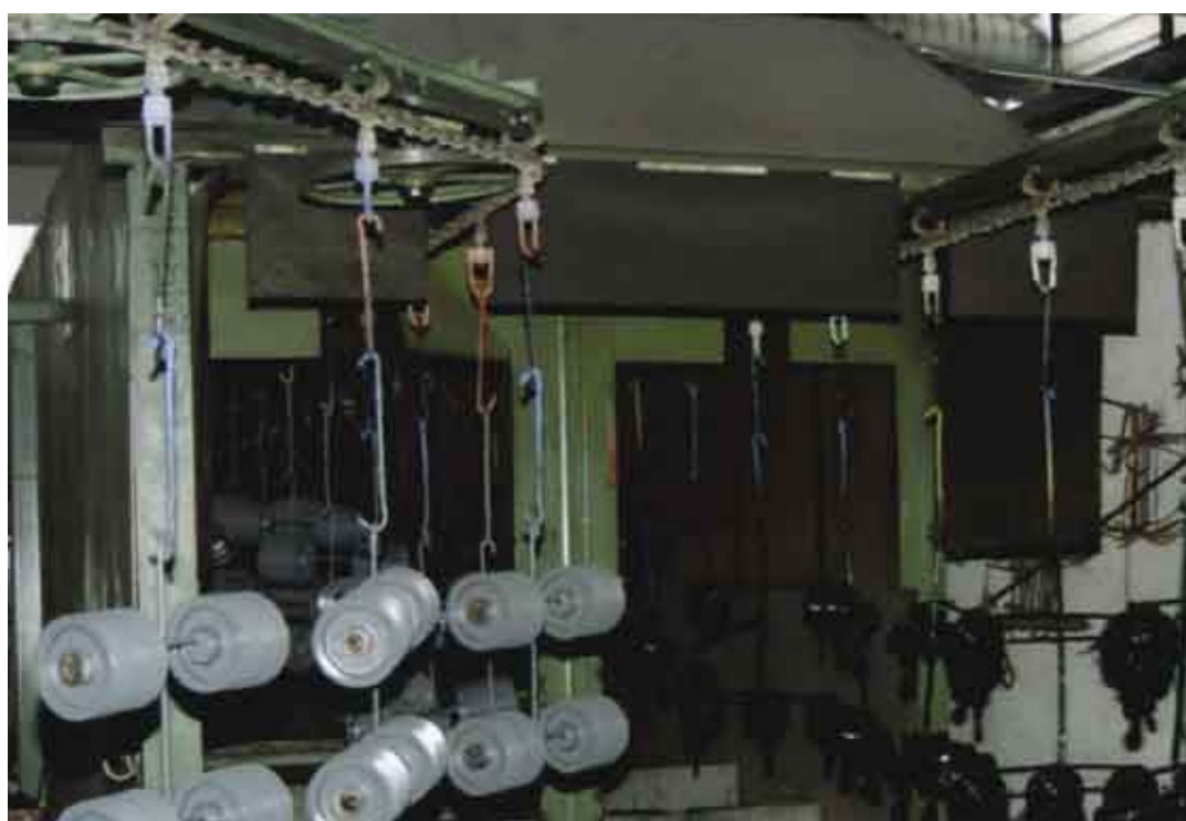
Fig. 3 - L'ingresso e l'uscita dei pezzi dal forno di asciugatura, a sinistra della figura
